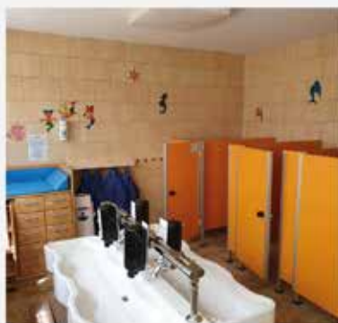
Der Sanitärraum im Kindergarten wird saniert. Aktuell werden Angebote für Fliesen- und Sanitärarbeiten eingeholt. Auch der Unterstand für die Kinderwagen wird bereits aufgestellt.
